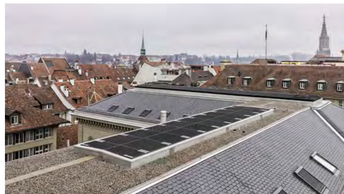
Im denkmalgeschützten Bau sind die Rückkühler unter Gittern verborgen
