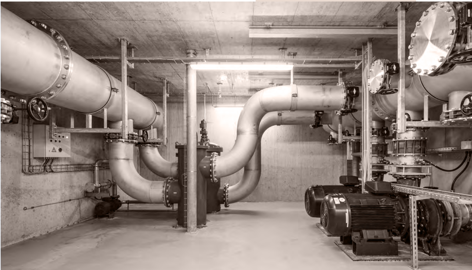
Zwei Optipro Grosswärmepumpen heizen das Gymnasium mit einer Heizleistung von insgesamt 524 kW.
